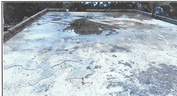
Foto 4: Módulo 2. terraza: estructura de metal y instalacion de techo para evitar que se siga deteriorando ya que en epoca de lluvias se filtra el agua a las aulas del primer nivel y las paredes se mantienen humedas.
